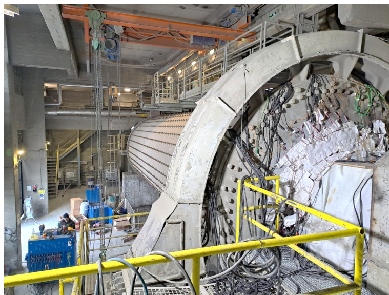
Slika 1. Mlin cementa sa lokacijom oštećenja u toku predgrijavanja
