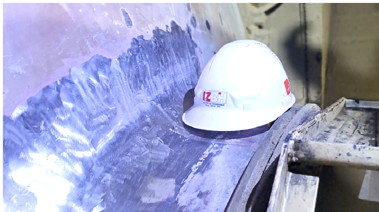
Slika 8. Obrušena površina nakon reparaturnog zavarivanja
